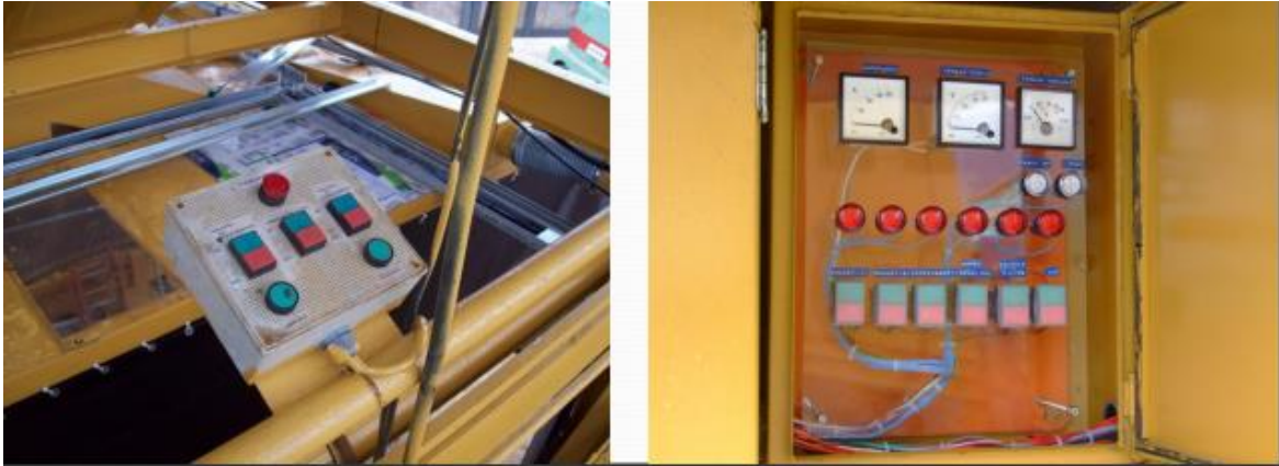
Painel de controle do funil, PRONAVE, 2011.
